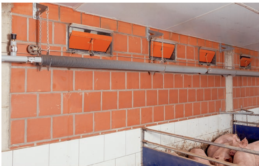
Отапливание помещений с помощью ребристой трубы из алюминия – идеально в сочетании с приточными клапанами
